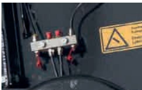
Punto di lubrificazione centrale
